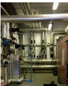
Die Wärmeenergie kommt vom benachbarten Holzbauunternehmen LignoAlp, zu sehen ist die Abgabestation.
